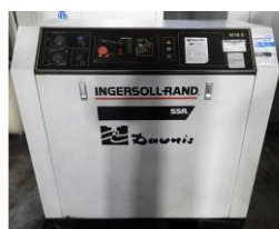
Referencia: CTB-157A COMPRESOR AIRE COMPRIMIDO 18.5KW Año: 1998 Marca: Ingersollrand Ancho mesa: .
