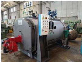
Referencia: AV7-014 GENERADOR VAPOR 1750kg Año: 2016 Marca: PERELLÓ I.VAR Ancho mesa: .
