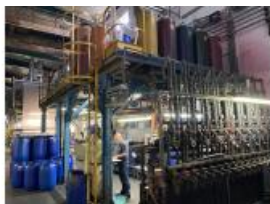
Referencia: STV-011 COCINA DE PREPARACION DE COLORES Año: 1992 Marca: TERMoelectTRONICA Ancho mesa: .
